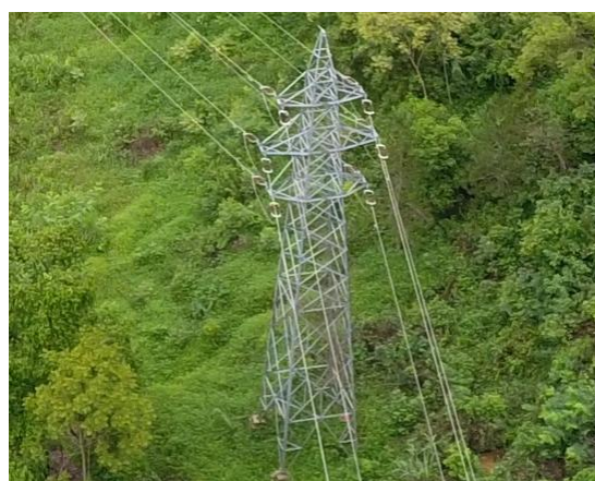
35kV 昌明线 4 号塔
