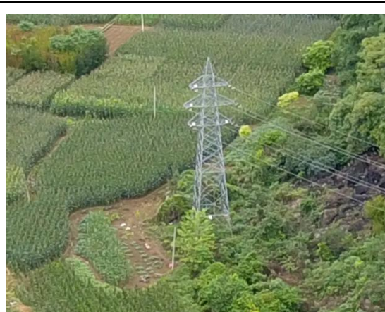
35kV 昌明线 6 号塔
