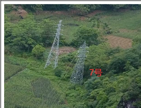
35kV 昌明线 7 号塔
