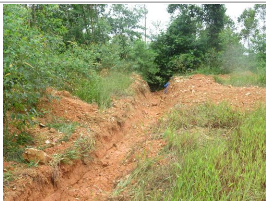
22#风机平台汇水导流沟
