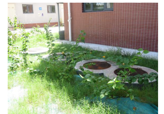
110kV 升压站污水处理系统
