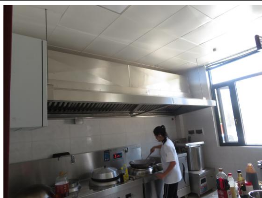
110kV 升压站食堂油烟净化装置
