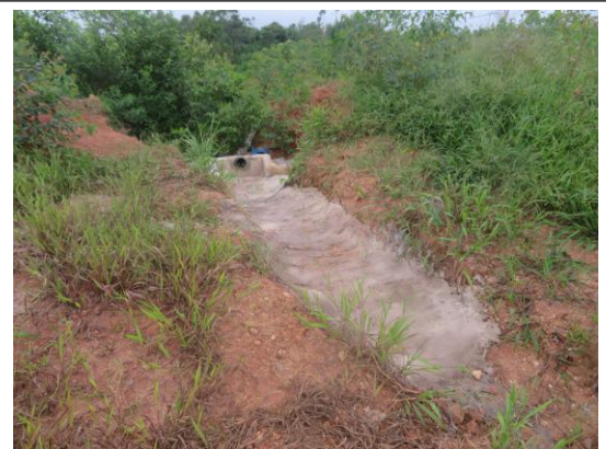
24#风机平台汇水导流沟和沉淀池
